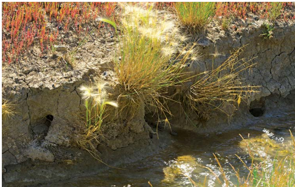
Разрушени брегове на напоителен канал вследствие ровещата дейност на северния рак Снимка: Jeff March / Alamy Stock Photo
